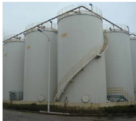
中粮东海粮油（张家港）特油罐区
