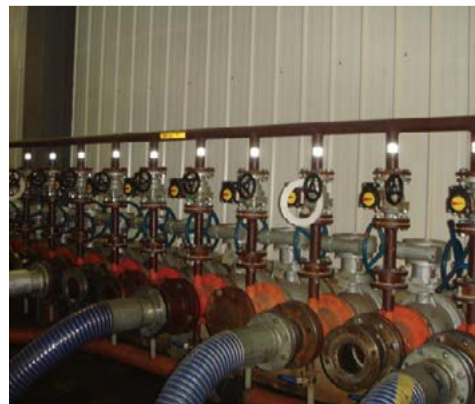
中粮东海粮油（张家港）车间工艺（2）
